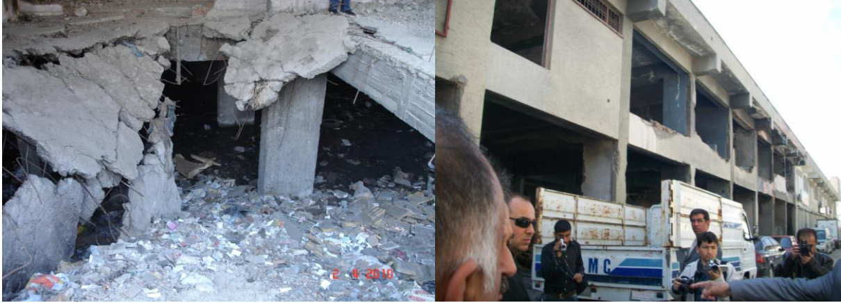
Resim 21. Batman Toptancılar Sitesindeki Patlama İzleri
